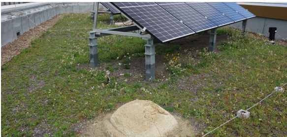
440 m 2 Dachbegrünung kombiniert mit Photovoltaik auf einem Gebäude der GEWOBA AG in Bremen
